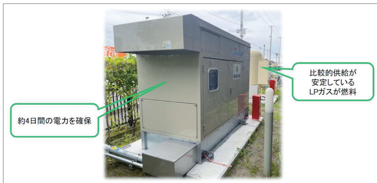
図1 非常用発電装置
